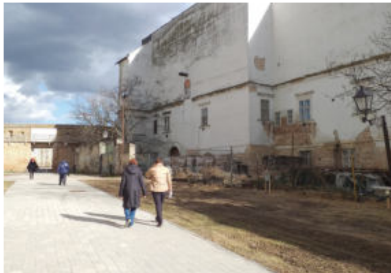
Miesto, kde sa zrútil múr je momentálne zabezpečené provizórnym oplotením.
